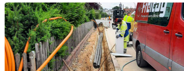
Juni 2024: Erdverkabelung zur Stromleitung für neues Baugebiet Weinbergweg, parallel Verlegung Leerrohre Glasfaser
