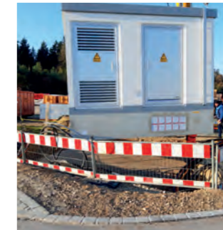
Oktober 2019: neue Trafostation 'Am Heidacker'
